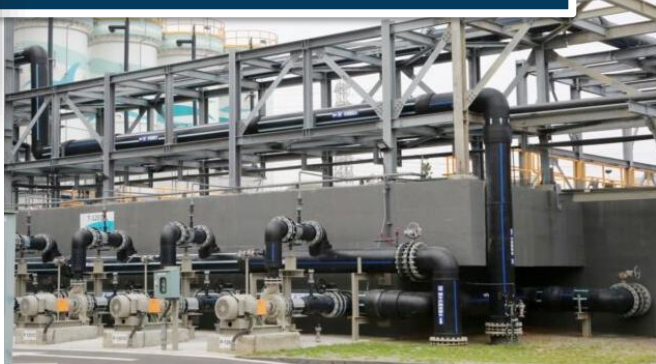
台積電南科再生水廠輸送管線
