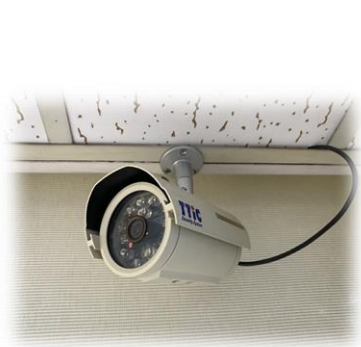
新設影像監控設施
